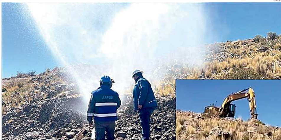
El agua desperdiciada no pudo ser cuantificada. En recuadro, el equipo pesado que causó el daño.
