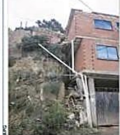
UNA VIVIENDA EN ALTO CALVARIO (CIUDAD DE LA PAZ) EN PELIGRO DE DESLIZAMIENTO.
