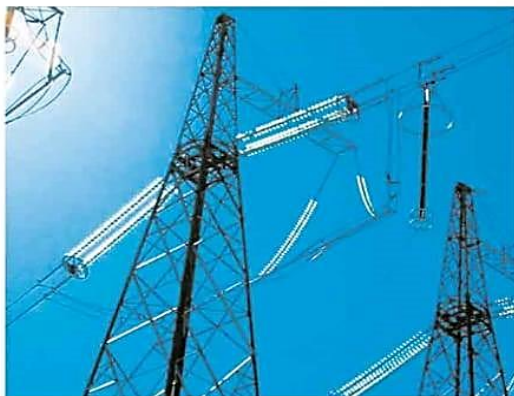
EL SISTEMA INTERCONECTADO NACIONAL (SIN) ES EL SISTEMA ELÉCTRICO QUE INTEGRA INSTALACIONES DE GENERACIÓN, TRANSMISIÓN Y DISTRIBUCIÓN EN LOS DEPARTAMENTOS DE LA PAZ, SANTA CRUZ, COCHABAMBA, ORURO, CHUQUISACA, POTOSÍ, BENÍ Y TARIJA.
