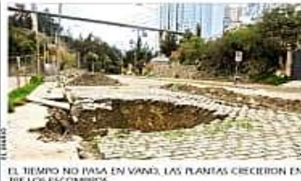
EL TIEMPO NO PASA EN VANO, LAS PLANTAS CRECERON EN ENTRE LOS ESCOMBROS.
