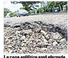
La capa asfáltica está afectada
