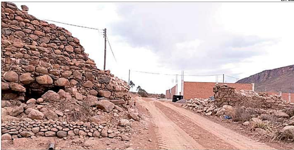
La gráfica muestra el deterioro del bien patrimonial y al fondo las nuevas construcciones.
